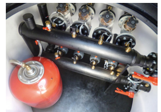
Arqueta para colector de distribución
